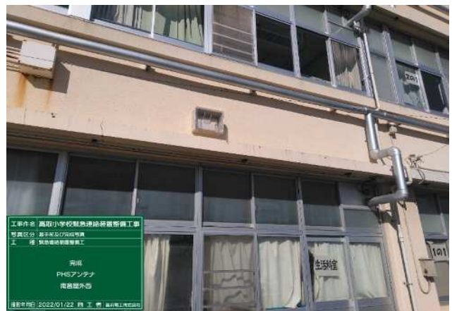
PHS基地局設置後
